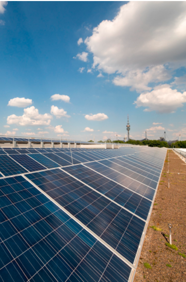
Photovoltaik-Anlage Agnes-Pockels-Bogen in München Foto: © Stadtwerke München / Nick Frank
