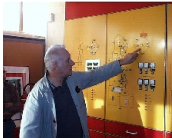
Bild 2: Haustechniker vor Schalttafel (Quelle: Stadt Hannover)
